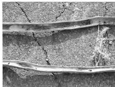
図-14 引き裂かれた鉛給水管
