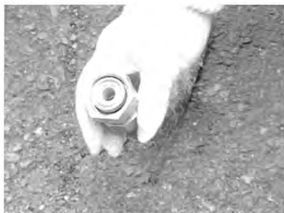
図-8 更生後の鉛給水管接続部
