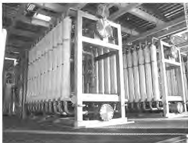
写真-2 膜モジュール配置状況
