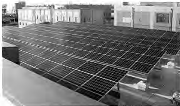
写真-3 太陽光発電設備
