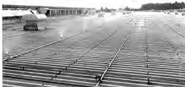
写真-1 屋根散水システムを設置した工場
