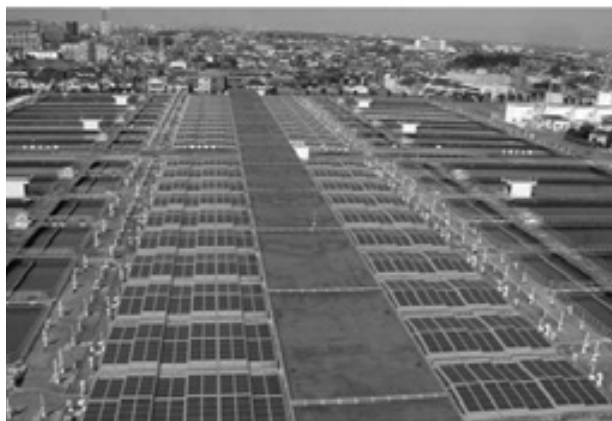
写真-1 太陽光発電設備(朝霞浄水場)
