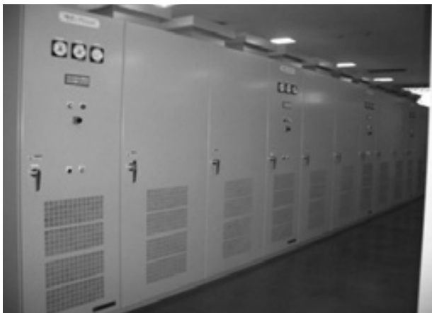
写真-1 インバータ制御盤
