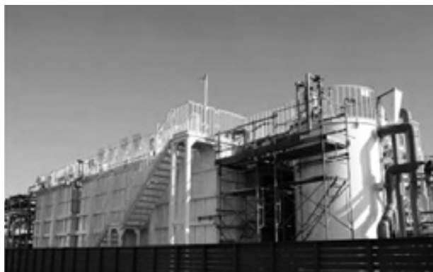
写真-4 ウォータープラザ全景(北九州市)
