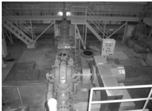
写真-2 インバータ制御方式のポンプ
