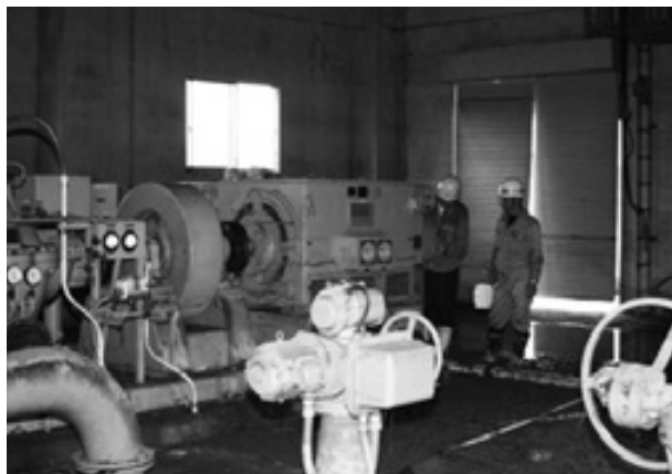
写真-3 被災後の送水ポンプ施設
