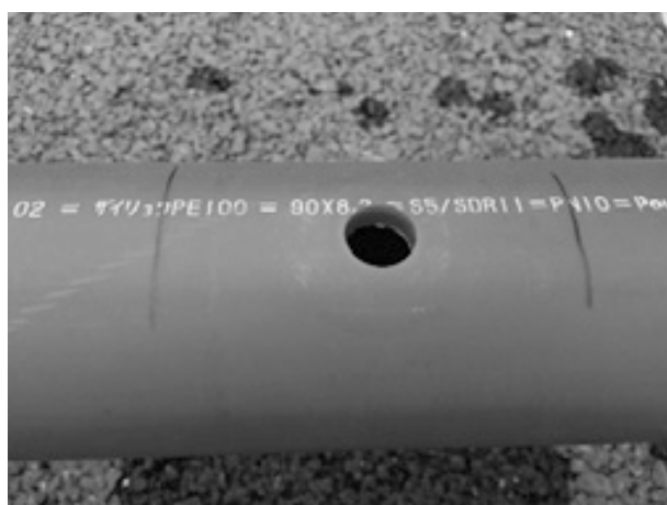
写真-13 穿孔状況
