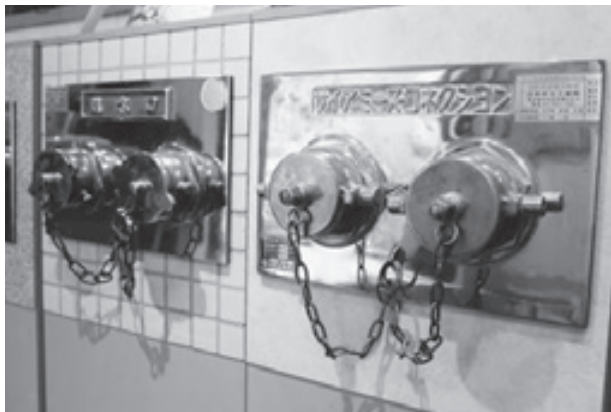
昭和 34 年設置の第二光和ビルに設置された送水口。 片仮名で「サイアミーズ」と表記されている。
