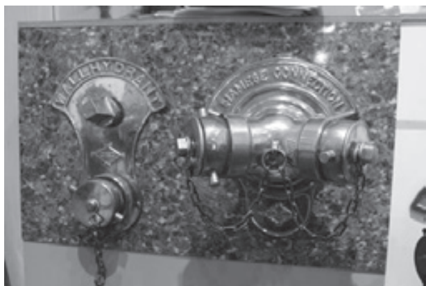
昭和 26 年にブリヂストン旧本社ビルへ設置された 送水口（右）と採水口（左）
