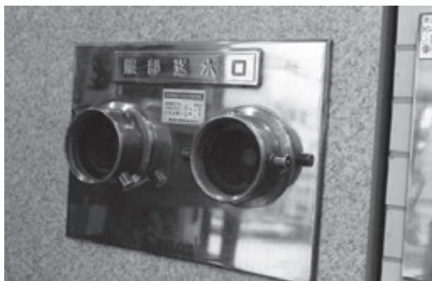
昭和 44 年竣工の旧パイロット本社ビルの送水口。 建築主の名前が記載されている。
