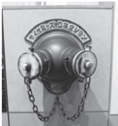
昭和 33 年設置の旧日本電池ビルディングの送水口。 片仮名表記になっている。
