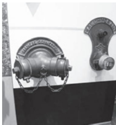
昭和 27 年竣工の旧日比谷ビルディングに設置された 送水口（左）と採水口（右）
