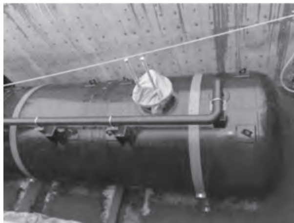
1階玄関前広場地下には10万Lの水道水を貯水できる耐震性貯水槽を設置。
