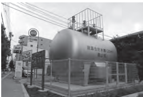
耐震性貯水槽
