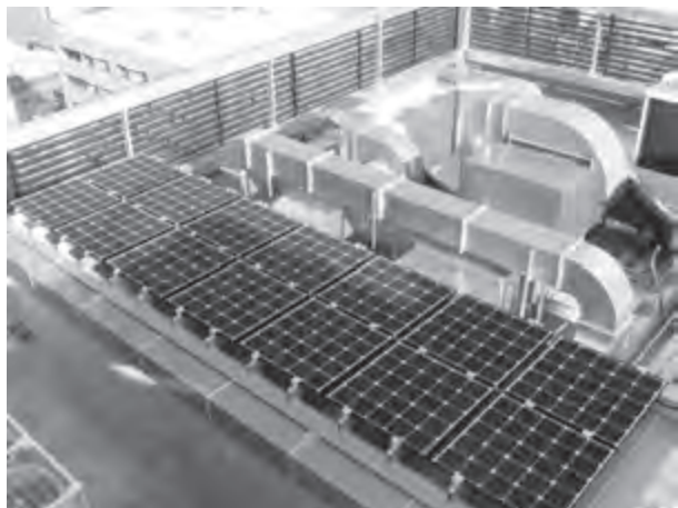
屋上に太陽光発電設備を設置し、建物の使用電力の一部に自然エネルギーを利用している
