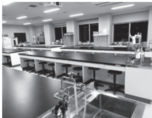
多数設置された給水栓の中には使用頻度が極端に低いものも存在する
