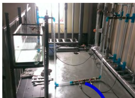
3F 給水管：A 配管
