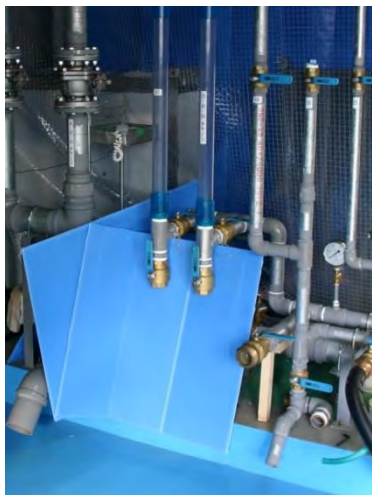
立管基部：50 同径（中央左透明管）
