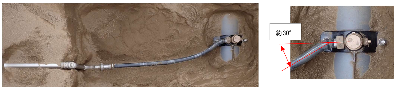
図 7-18 サドル付分水栓及び給水管の変形状況
