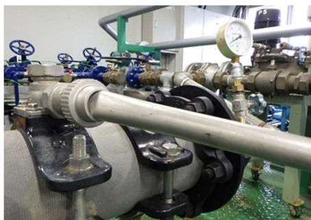
図 7-32 耐震試験後の供試品 2
